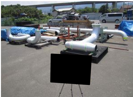
復水配管(エルボ付) 500A
